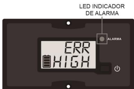
7. Protección por alto voltaje de batería
